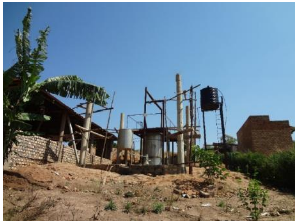
SORAK が所有するエッセンシャルオイルの蒸留機。農家からレモングラスを収集し、ここでレモングラスのオイルを生成している。
