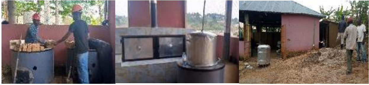
揚げるのに使用する省エネのストーブ、薪オープン（完成形）と蒸し器、建設中のパン工場
