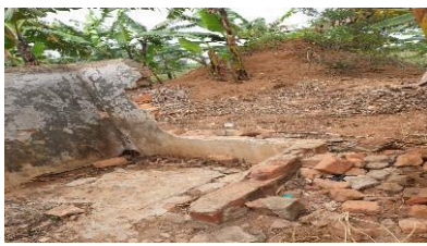
崩壊した女子トイレ。ドア付きバスルームの再建設が必要である。(Butende 小学校)
