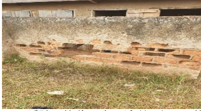
凹んだ壁の修復、床の塗装、ドア2枚の取り付けが必要なトイレ (Butende 小学校)
