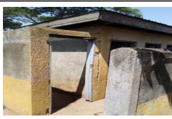
ドアの取り付けと床の修理が必要な洗面所 (Kitungwa 小学校)
