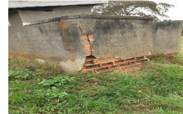
床の塗装を含む修繕が必要な洗面所 (kiwala 小学校)
