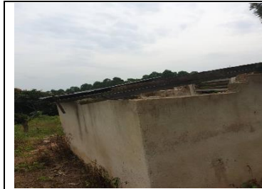
屋根、ドア、床の塗装が必要な女子トイレ。屋根が外れてから、男女が同じトイレを使用している。(Kitagobwa 小学校)
