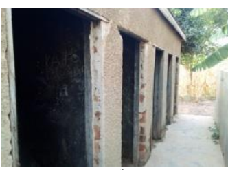
ドアの取り付けが必要 (Buwambo 小学校)
