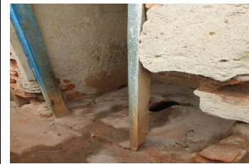
プライバシーがなく、本格的な修復が必要なトイレ。洗面所がないため建設が必要である。(Nkokoma 小学校)
