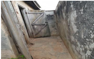
新しいドアの設置と床の塗装、壁の補修が必要。(Bule 小学校)
