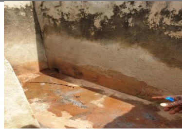
セメントを塗る必要がある洗面所 (Kitagobwa 小学校)
