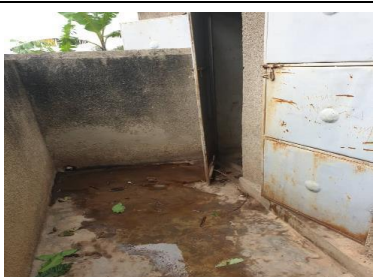
粗末な排水状態であり、多数の生徒が共用することで感染症のリスクが生じる。溝を備え付け、床を塗装する必要がある (Kayenje 小学校)
