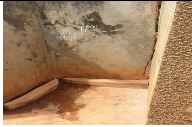
ドアの取り付けと床の塗装が必要な亀裂の入った洗面所 (Nawango 小学校)
