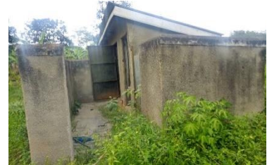
床の塗装とドアの取り付けが必要 (Butalunga 小学校)
