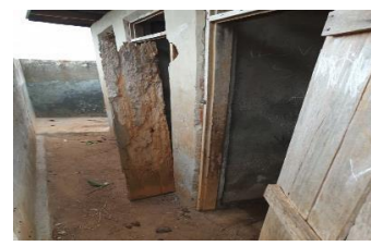
ドアがシロアリに食べられていたため新しいドアの設置と床の塗装の必要がある。(Kiwala 小学校)
