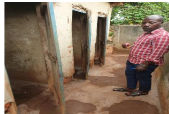
チームリーダーがトイレの視察している。施設はドアと鍵の取り付け、床の塗装が必要 (Nkokoma 小学校)
