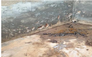
床の塗装を含む修繕が必要な洗面所 (Butalunga 小学校)
