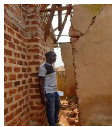
プログラムマネージャーが更衣室として使用できる部屋を視察している。この部屋は修繕とドアの取り付けが必要 (Ntolomwe 小学校)
