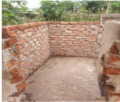
<修繕後> 洗面所としてトイレを使用していたため、新たに洗面所と更衣室を建設中である。
