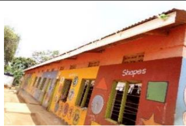
<修繕後> 集水樋ホルダーを取り付けた。樋も今後設置予定である。
