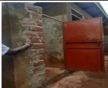
<修繕後> ドアを取り付けた洗面所。 漆喰塗装は作業途中である。
