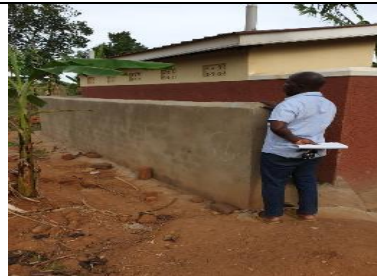
<修繕後> 新しく洗面所を建設した。今後ドアや屋根を取り付ける予定である。
